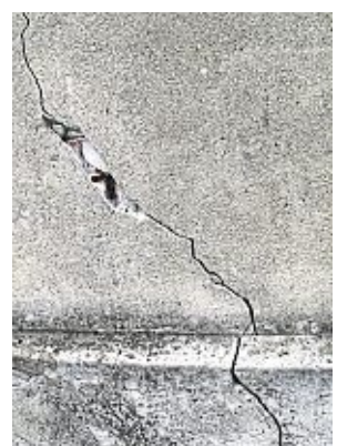
Die Fassade sollte vor dem Winter auf Risse überprüft werden, sonst kann Feuchtigkeit ins Gemäuer eindringen. Foto: Andrea Warnecke/dpa-mag
